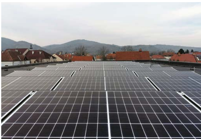
Ein Teil der PV Anlage am Dach des Kindergartens
