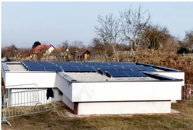
PV Anlage am Hochbehälter Mautern
